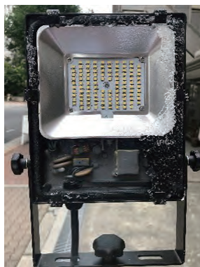
NLFL投光燈 燈具玻璃破碎情況
